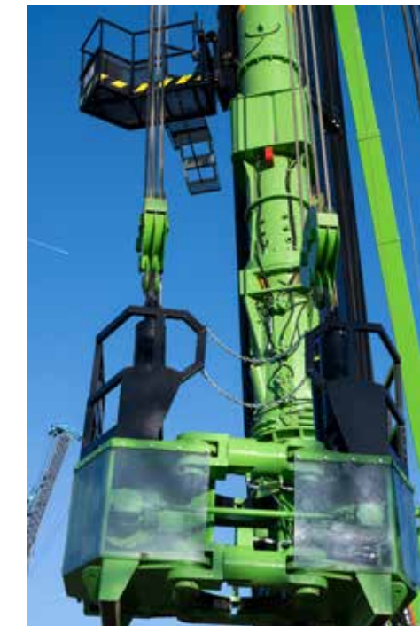
De 170 ton wegende 160 DR wordt in de Amaliahaven in Rotterdam ingezet met een D100 heihamer en een ringtrilblok met 100 ton trekkracht.
